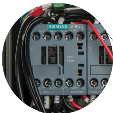
SIEMENS besturingssysteem / SIEMENS relais
